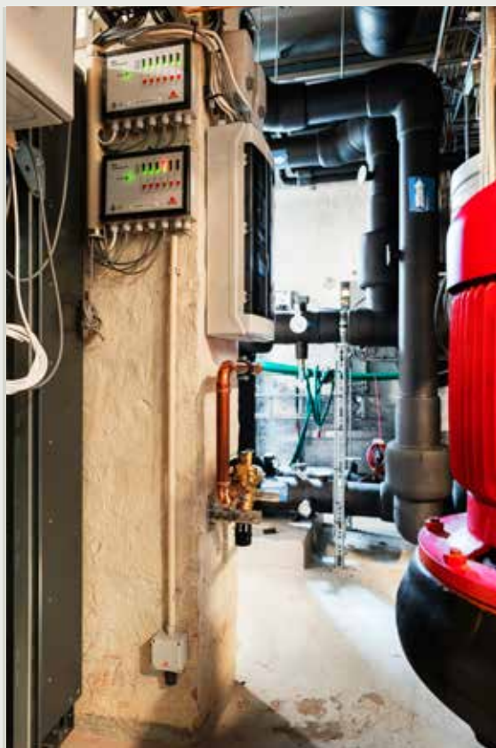
Nærvarme: Propanvarmepumpen løfter nærvarme fra sjøvannsvärmepumper opp til maksimalt 65 °C varme.
