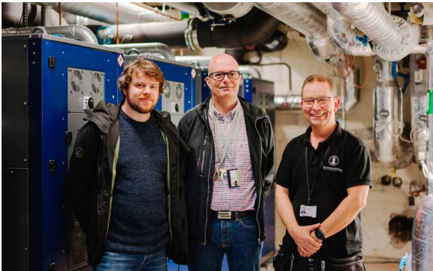
Fornøyd: Rådgiver Jørgen Bakke Skauge i Sweco (fra venstre), overingeniør Steinar Sundberg og driftstekniker Paal Astrup-Rønquist ved Universitetet i Bergen konstaterer at anlegget går over enhver forventning.
